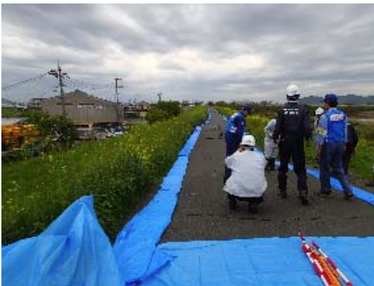
地方整備局職員との被災状況調査(4月16日) (緑川の堤防被災箇所)
