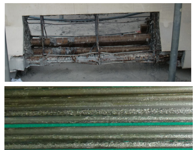
撤去桁下桁の解体調査 PC鋼線の腐食による断面減少の状況
