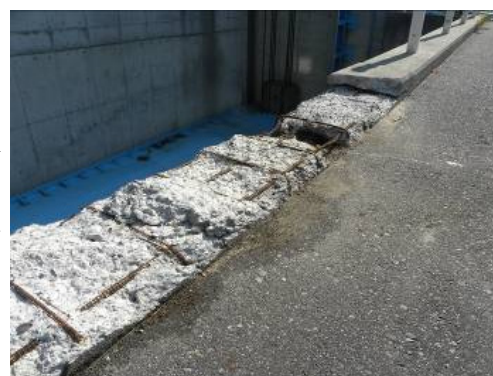
地覆部の圧壊
