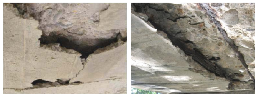
床版下面の剥離
