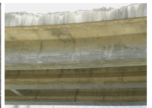
主桁に多数の曲げひび割れ
