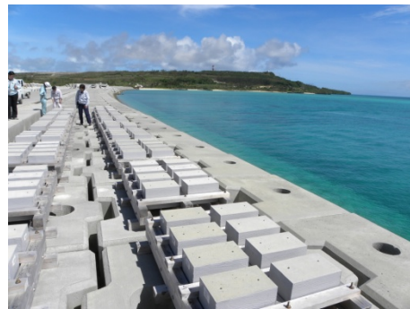
現地暴露供試体(181体) 実際の下部工に使ったコンクリートと同じ材料・同じ配合
