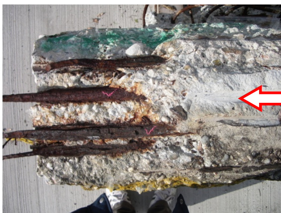
露出した鉄筋
