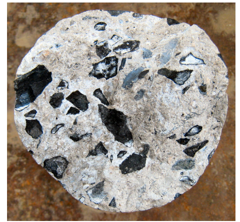
アルカリ骨材反応によるゲルの滲出
