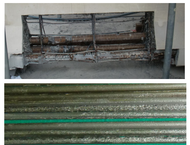
撤去桁下桁の解体調査 PC鋼線の腐食による断面減少の状況
