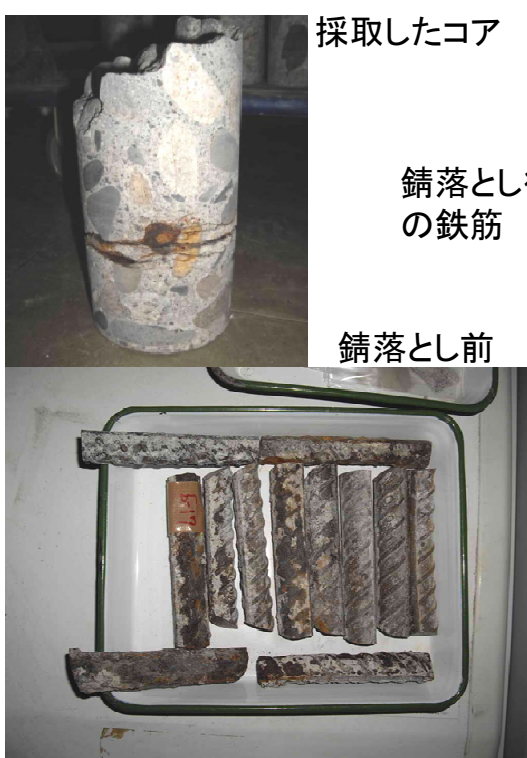
撤去橋脚の鉄筋の腐食程度
