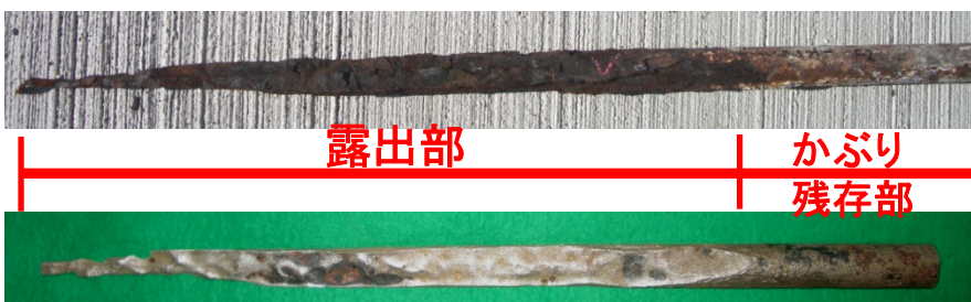
除錆前後の鉄筋状況
