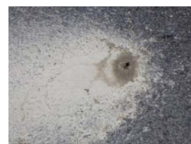
(b) 舗装面の土砂噴出
