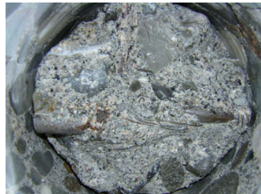
鉄筋の状況 (脱塩施工後 10 年)
