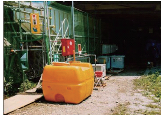
電解質溶液タンク
