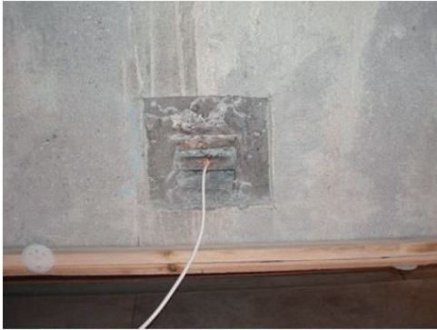
内部陰極接続状況
