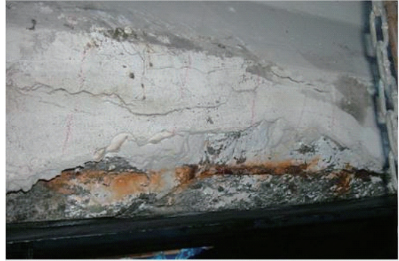
施工前の断面修復部の再劣化
