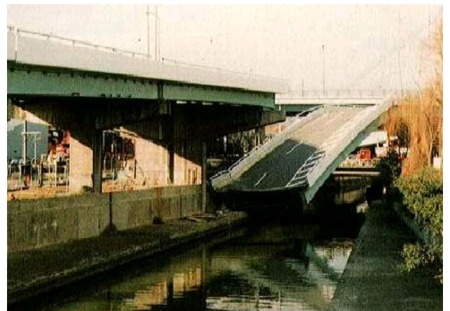
写真. 曲線橋の落橋(兵庫県南部地震)
