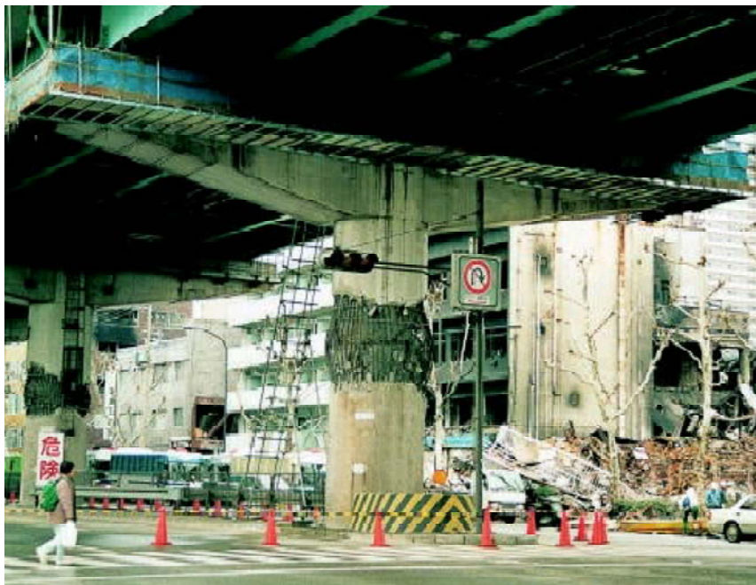
写真. 兵庫県南部地震における単柱橋脚段落し部の破壊
