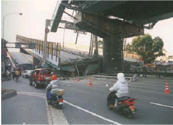
写真. 単純桁形式の高架橋の落橋(兵庫県南部地震)
