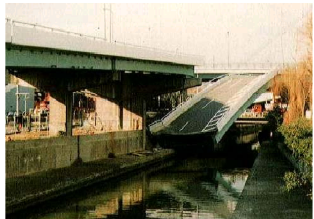
写真. 曲線橋の落橋(兵庫県南部地震)
