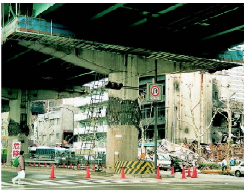
写真. 兵庫県南部地震における単柱橋脚段落し部の破壊
