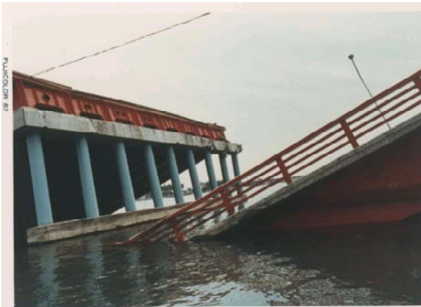
写真. 液状化・流動化による落橋(新潟地震)
