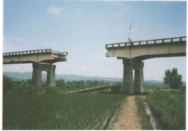
写真. ゲルバー桁橋の落橋(宮城県沖地震)
