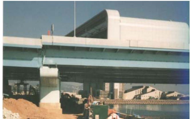
写真. 流動化による橋脚基礎の変位(兵庫県南部地震)
