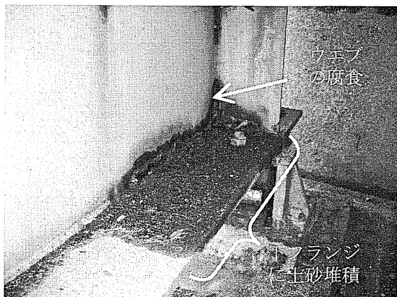
(e) 土砂堆積による腐食
