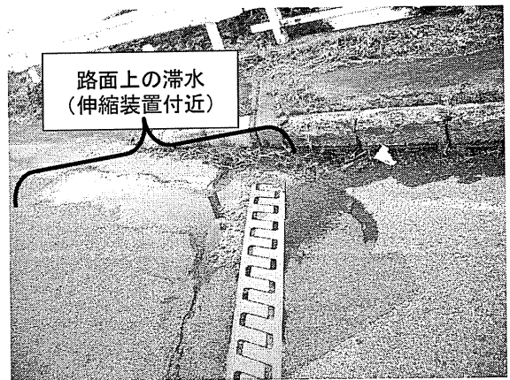
(b) 伸縮装置の状況(左図と同じ橋梁)
