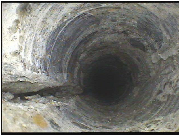
図一解 10.3.3 小径コア（φ25mm）とファイバースコープを用いてひび割れ深さを調査した事例
