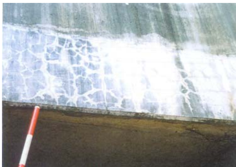
図一解 2.1.9 表面モルタルのひび割れ
