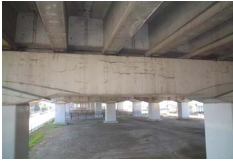
図一解 2.1.3 主鉄筋方向が卓越したひび割れ
