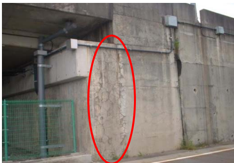
図一解 2.1.7 水分供給部の著しい ASR 劣化
