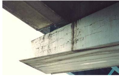
図一解 2.1.4 PC鋼材方向が卓越したひび割れ
