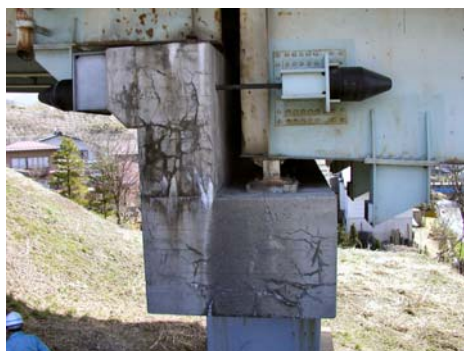
図一解 2.1.1 網目状のひび割れ
