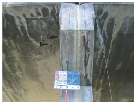
図一解 2.1.10 橋脚張出し部の腐食ひび割れ
