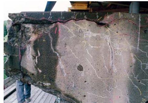
図一解 2.1.8 雨水を受ける張出し部の著しい ASR 劣化
