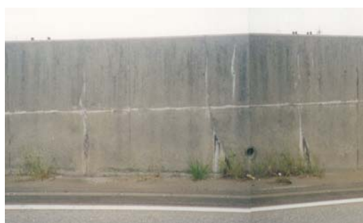
図一解 2.1.12 水和熱及び乾燥収縮によるひび割れ
