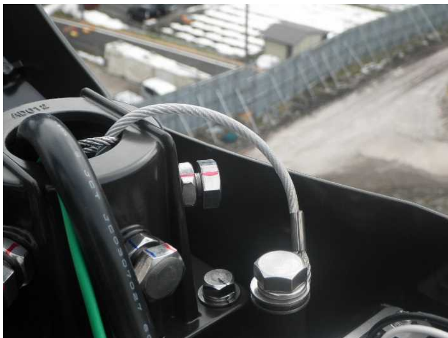
灯具の落下防止対策の事例
