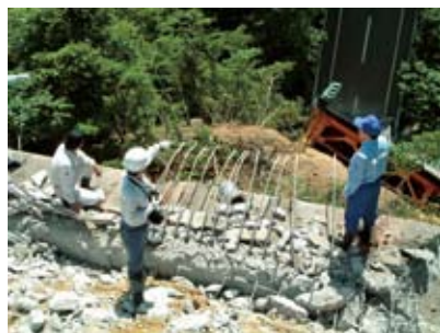
落橋した祭時大橋の調査
