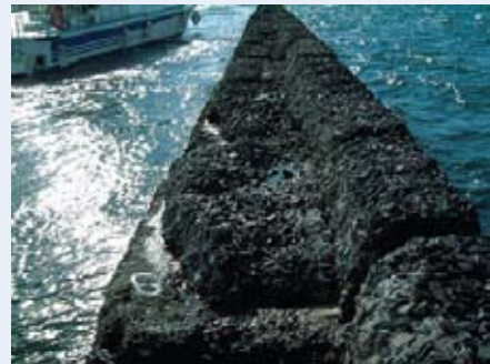
写真-1 スケーリング被害例
