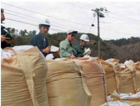
斜面崩壊への応急対策(土のうの設置)とその効果の確認の様子
