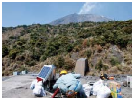
【H20.3 自動降灰量計の設置】
