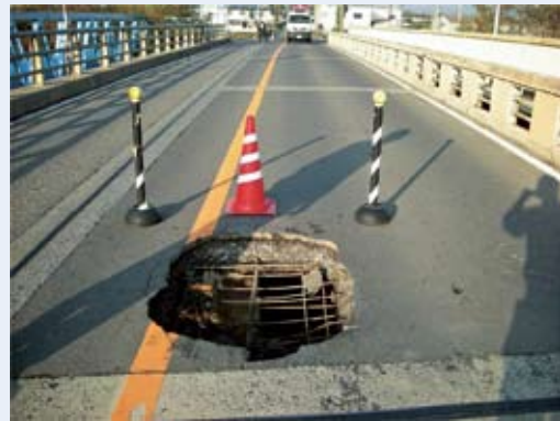
供用中における重大損傷事例
