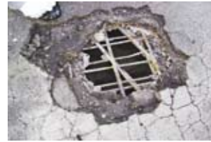
陥没が生じたRC床版
