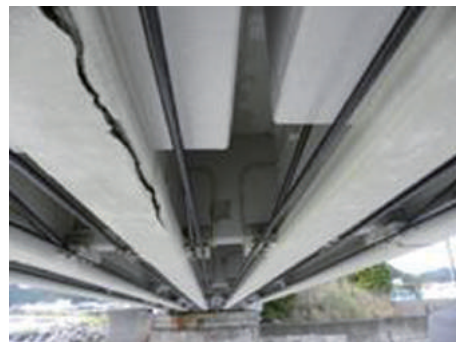
塩害橋の再劣化状況
