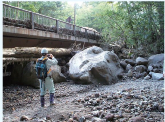
写真-2 国道453号の土石流災害
