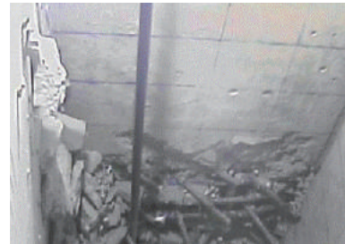
(b) 内面の損傷
