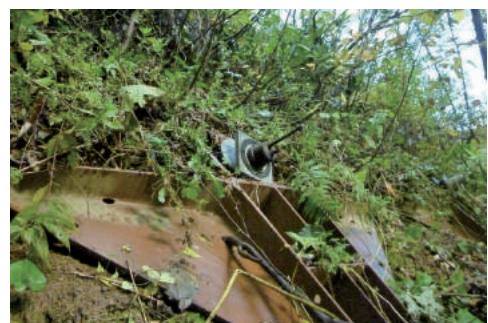
アンカー頭部の破損発生状況
