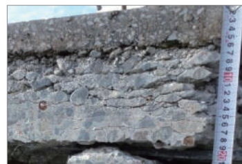
RC床版の層状 ひび割れ状況
