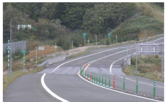
図-14.3 泥炭地盤上の道路の不同沈下
