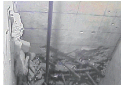
(b) 内面の損傷
