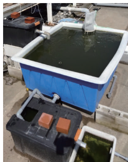
藻類を活用した下水処理法の実証装置
