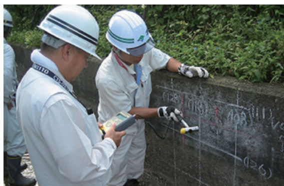
図-14.4 開水路の内部劣化の検出
