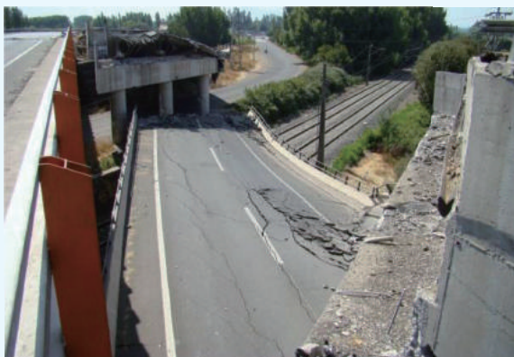
写真-1 2010年チリ地震による高速道路の落橋被害（チリ共和国公共事業省 MOP 提供）
