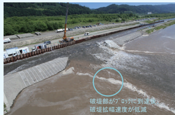
写真-2 ブロックにより破堤拡幅が抑制 （越水開始から約30分後）
