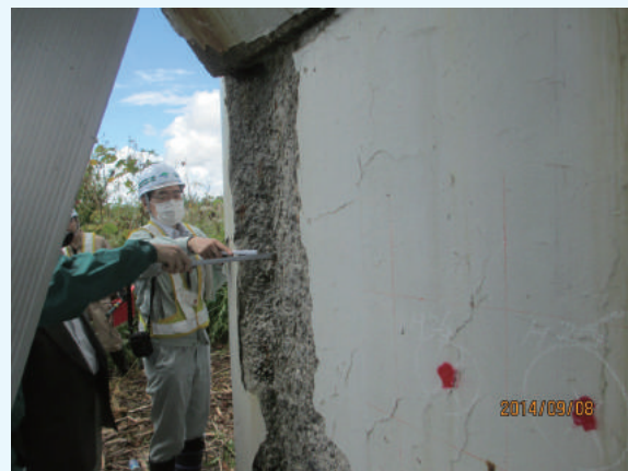
図-2 剥離度の測定
