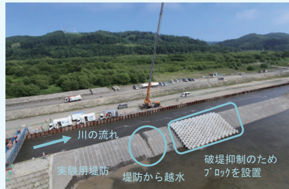
写真-1 水位が上昇し堤防から越水
