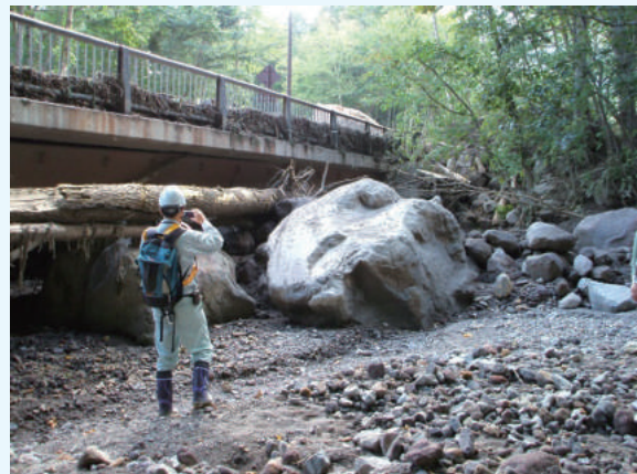
写真-2 国道453号の土石流災害
