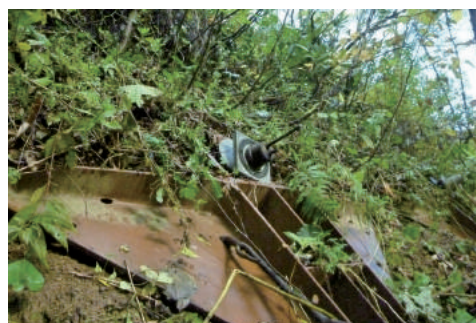
アンカー頭部の破損発生状況
