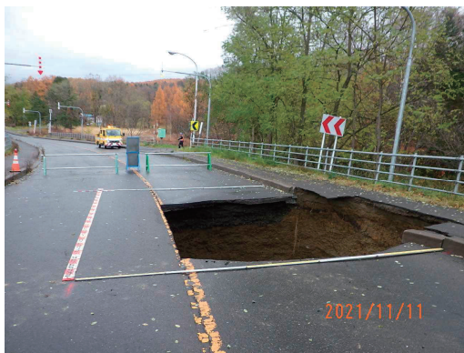
写真 - 1.2.3.5 道道岩見沢桂沢線の路面陥没の状況
