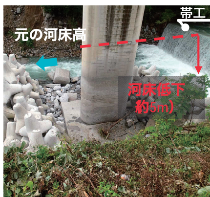
写真 - 1.2.3.5 洗堀によって基礎が露出した橋梁
