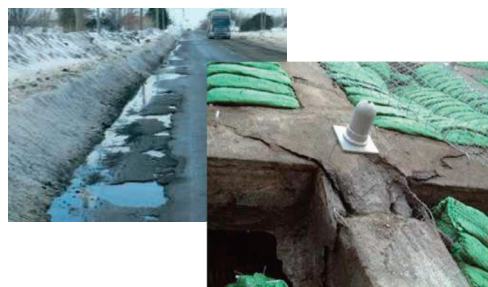
写真-2 凍上や融雪水による損傷（道路舗装・コンクリート法枠）
