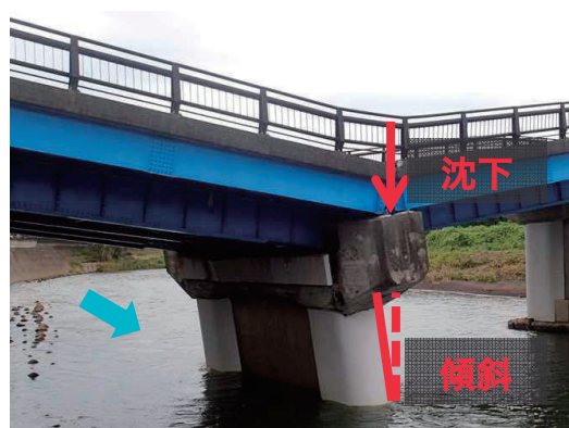
写真 - 1.2.3.6 洗堀が原因とみられる橋梁の沈下・傾斜
