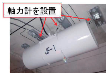
写真-1 トンネル現場でのジェットファン取付部材の軸力計測状況
