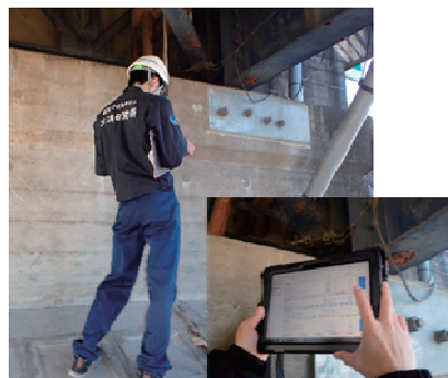
写真-1 システムの現場実証の状況
