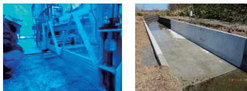
図-9 コンクリートの凍害・摩耗劣化と高耐久性断面修復・表面被覆技術
