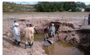
写真-1 地震災害における農業用管水路の継手部離脱による漏水事故の状況
