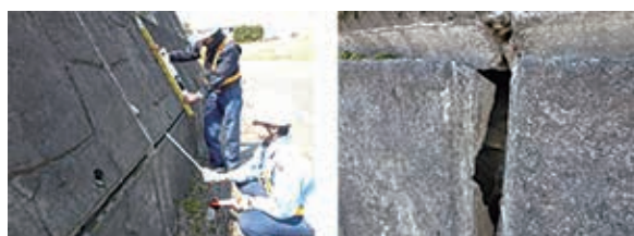
図-5 熊本地震における大型ブロック積み擁壁の被害調査と分析状況
