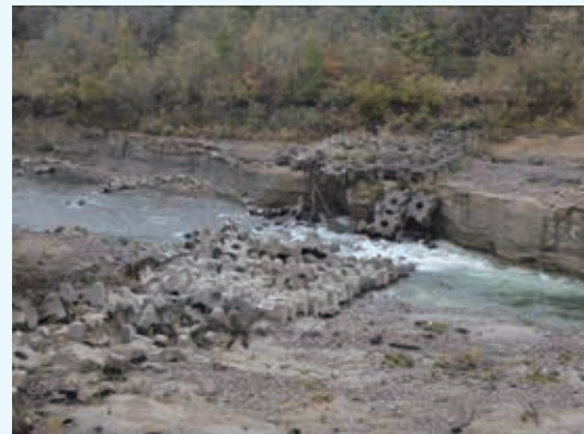
写真-1 岩盤侵食による帯工の被災
