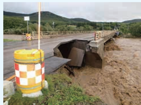
写真-2 大平橋の被災
