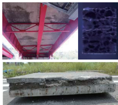
写真-3 橋梁床版の劣化状況
