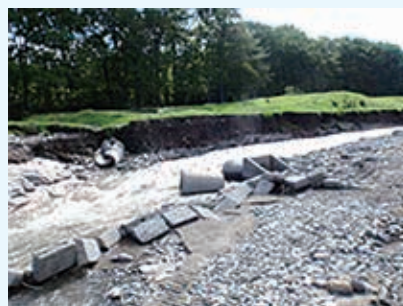
写真-1 水路護岸の損壊と法面の侵食状況
