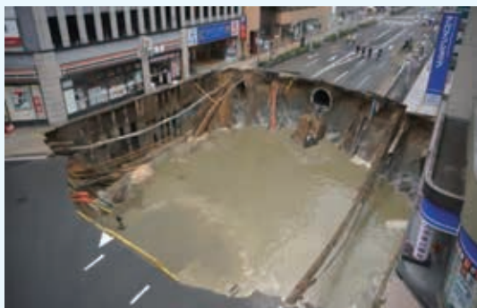
写真-1 道路陥没状況（福岡市交通局ホームページより引用）
