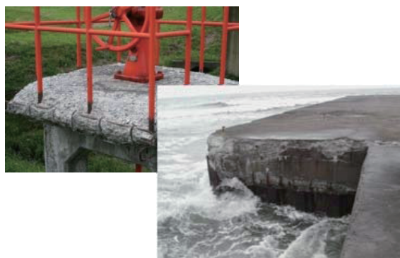
写真-1 凍害や塩害・摩耗との複合劣化（樋門・沿岸構造物）
