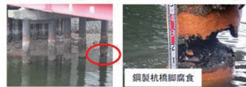
■見晴橋（市道 新山下第8号線）は、37歳で損傷を発生
