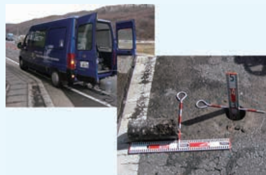
写真-1 舗装の損傷実態調査
