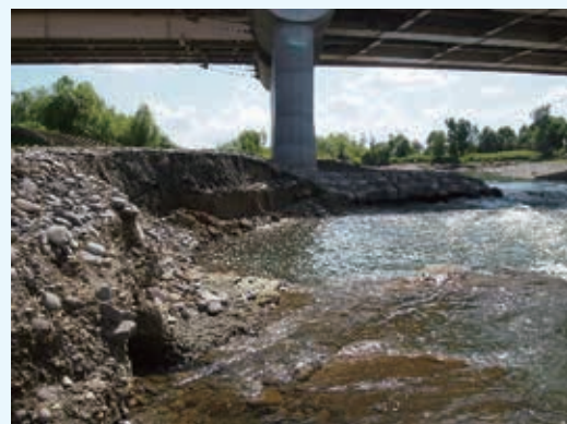
写真-2 橋脚付近における急激な河床低下
