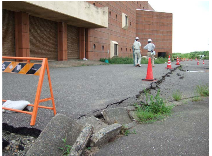
新潟県中越沖地震 (柏崎市自然浄化センター)
