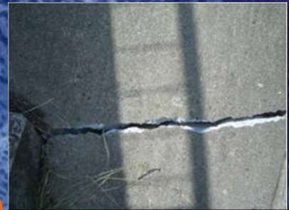
放流渠法面防護壁の亀裂
