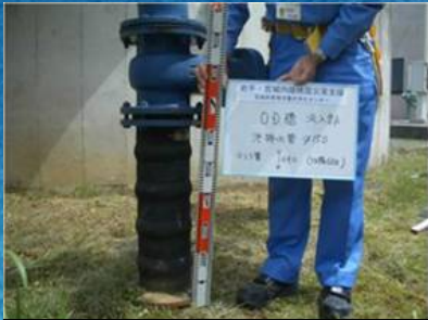
池排水管用可とう管の伸び
