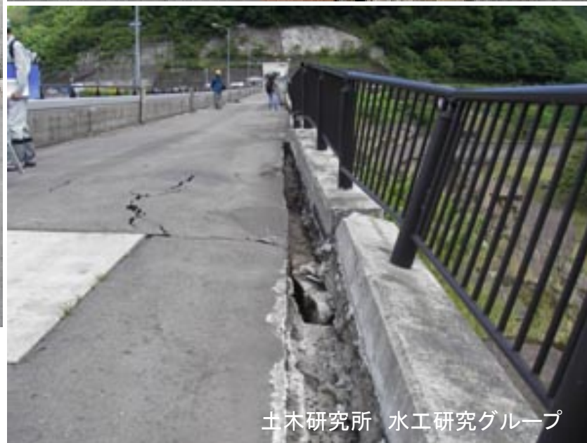
天端上下流法肩の開き
