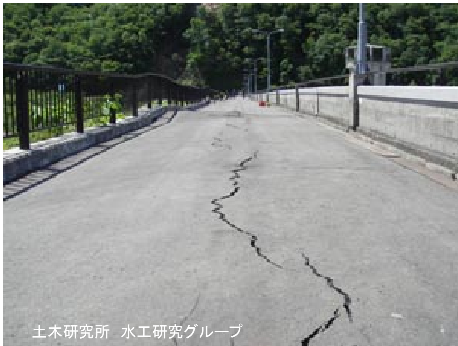
天端舗装のクラックと波打ち
