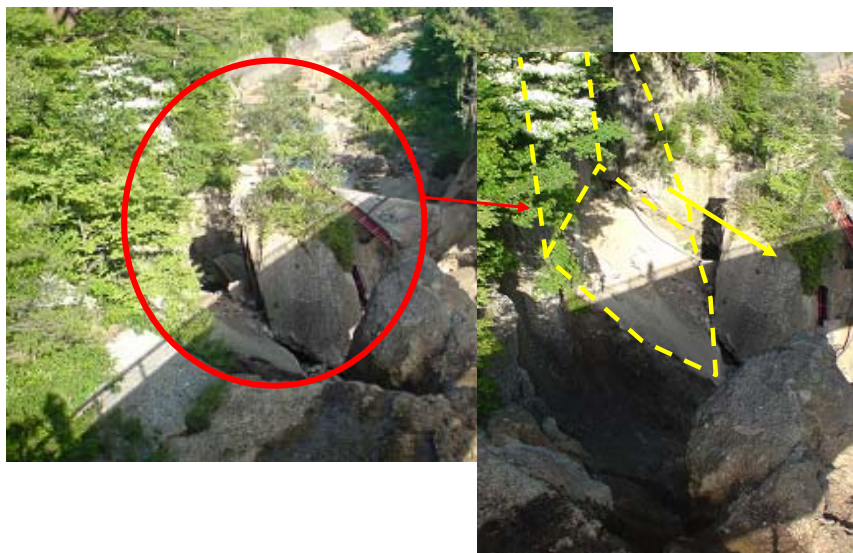
崩落した旧道橋および節理面の状況
