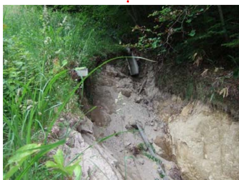
縦排水溝流末の浸食
