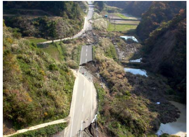
沢埋め盛土の崩壊例(中越地震)
