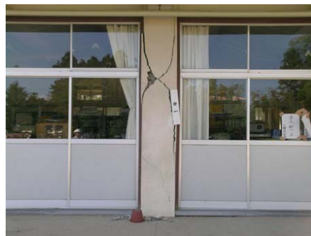
1F東側柱せん断ひび割れ (ほぼ全数)
