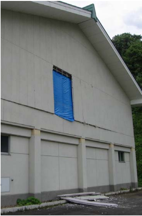
外装ALCパネル脱落 (学校体育館A)
