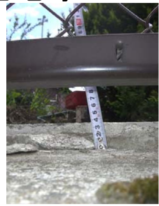
水路際の地盤沈下(約3cm)
