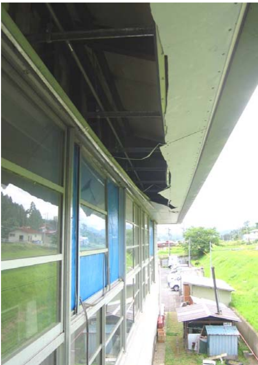
体育館軒天の天井板の被害 (学校体育館C)
