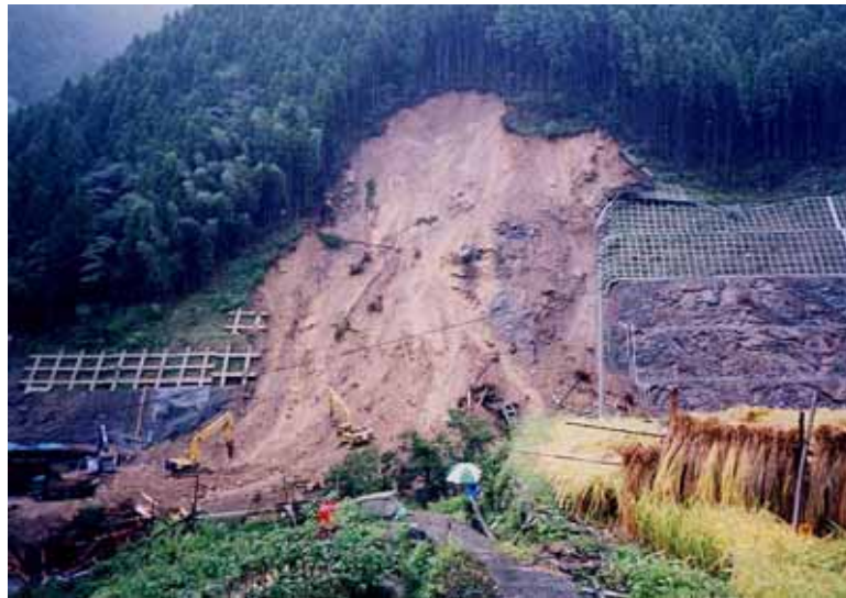
切土のり面工事による上部斜面の表層崩壊 (1998.9.19 高知県馬路村)
