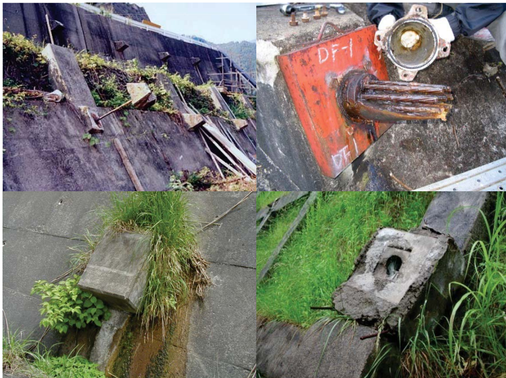
グラウンドアンカーの変状事例
