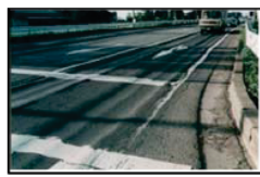
(舗装のわだち掘れ)
