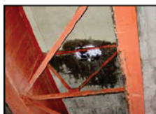
(橋梁の抜け落ち)
