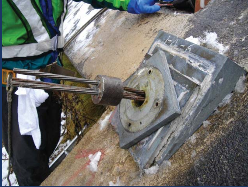
頭部の浮き上がり (定着地盤の劣化による定着部の引き抜け) 5
