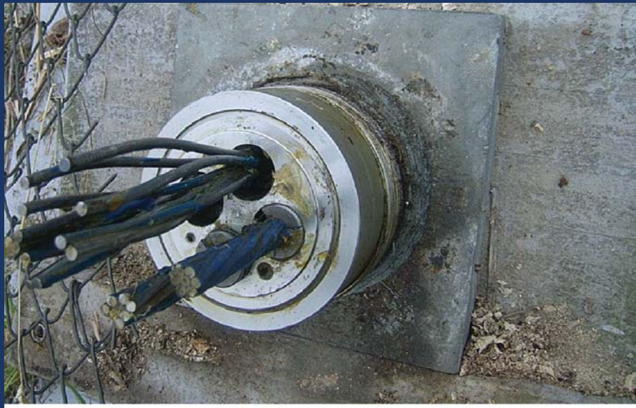
供用後の斜面変状によるアンカー損傷(破断) 過緊張(オーバーロード)
