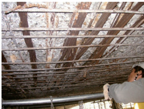
図-1 PC鋼材の腐食・破断
