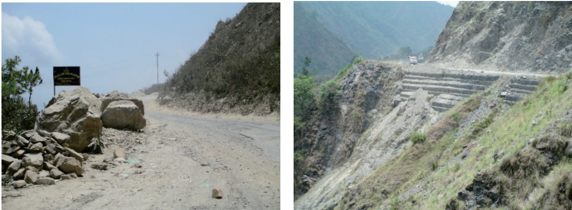
写真-6 クレカンに向かう道路の落石、斜面の崩壊
