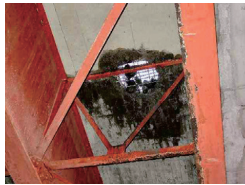
図-2 床版の抜け落ち
