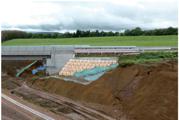
図-21 盛土内部構造調査を適用した盛土変状発生箇所の外観
