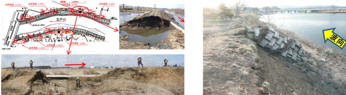
河川津波による被災
