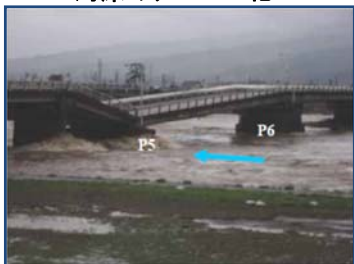
橋脚周辺の局所洗掘
