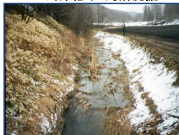
排水路での土砂の堆砂
