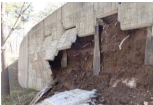
壁面材の脱落(補強材破断)
