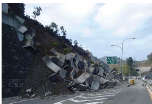
のり面の崩壊
