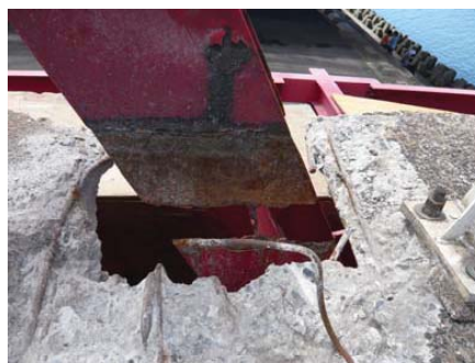
鋼トラス斜材の破断（2007年，国道23号木曾川大橋）
