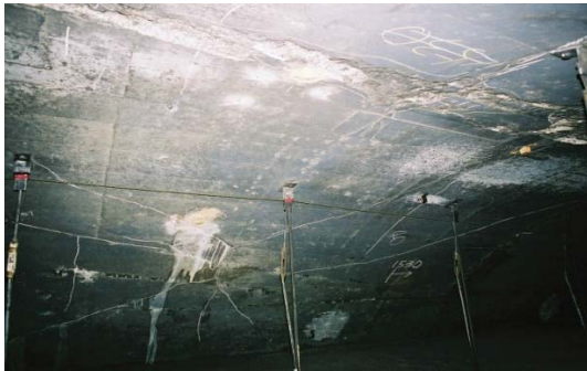
外力作用により覆工コンクリートに発生したひび割れ（圧さ）
