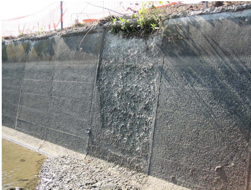
層状ひび割れが生じはく落に進展した事例
