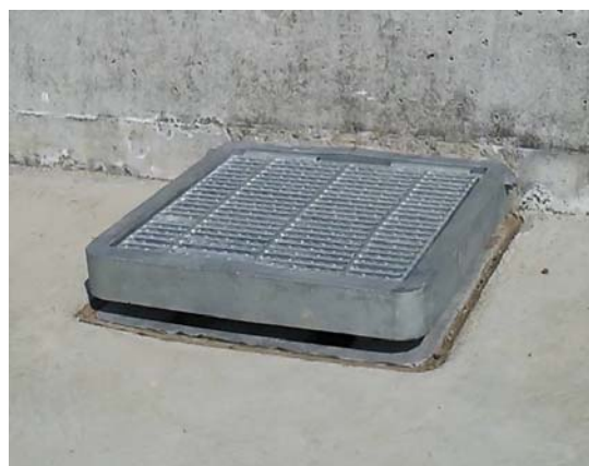
現地設置状況
