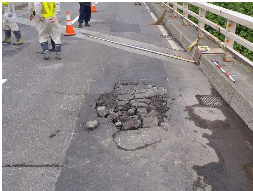
床版内部までの劣化損傷の進展
