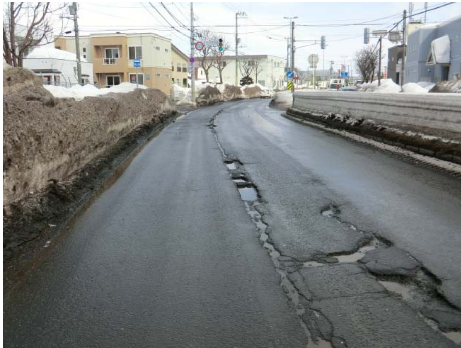
ポットホールの発生状況
