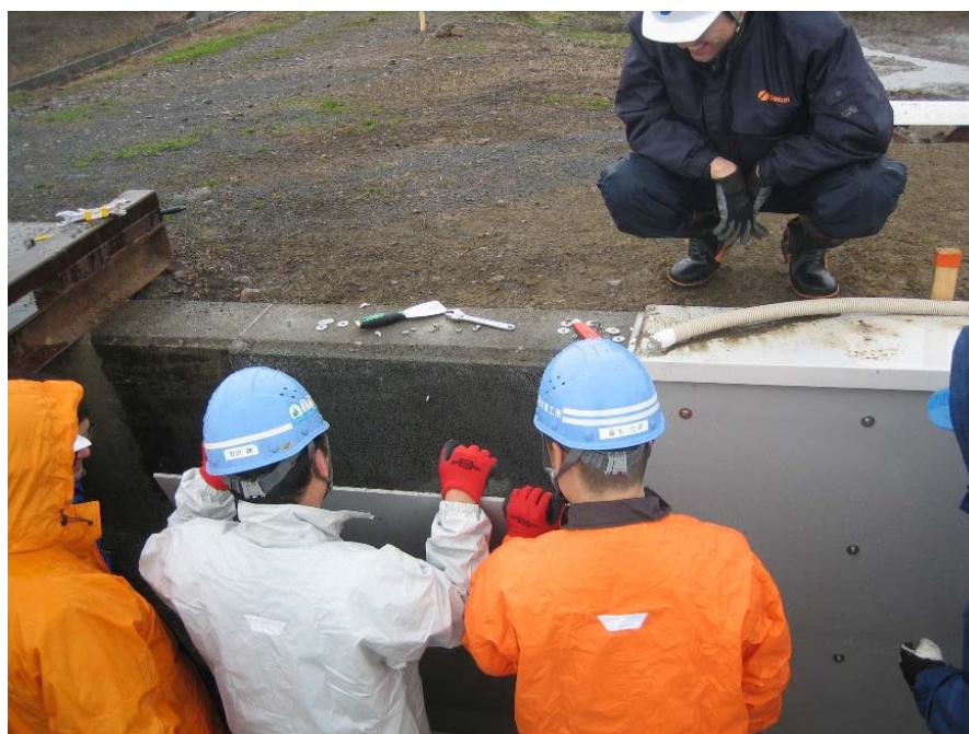
FRPM板の取外し後のポーラスコンクリートの観察状況
