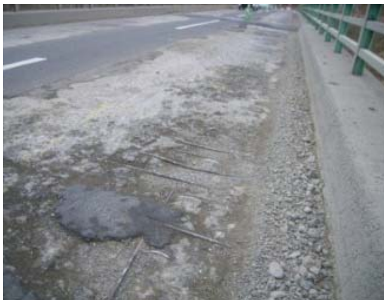
床版上面の砂利化（土砂化・骨材化）
