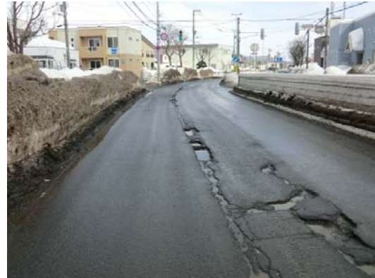
ポットホールの発生状況
