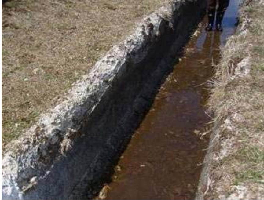
スケーリングが生じた事例
