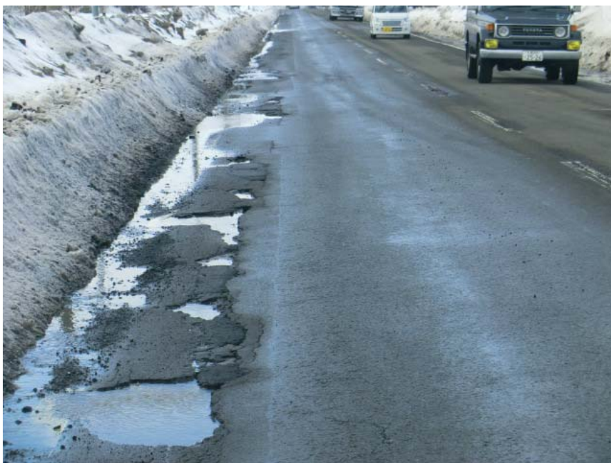
路肩の堆雪からの融雪水が影響したポットホール
