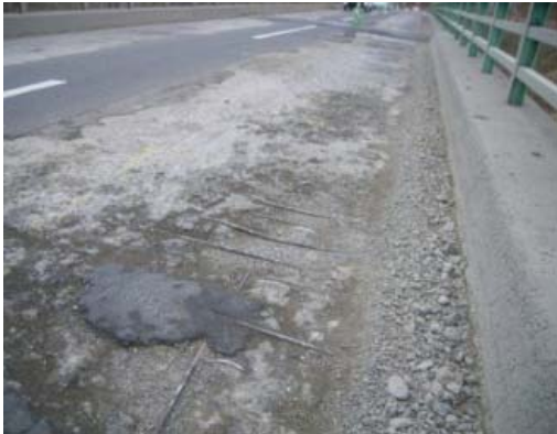
床版上面の砂利化（土砂化・骨材化）
