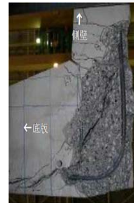
(c) 隅角部損傷 (下側)
