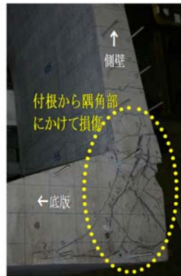
(b) 隅角部損傷 (上側)
