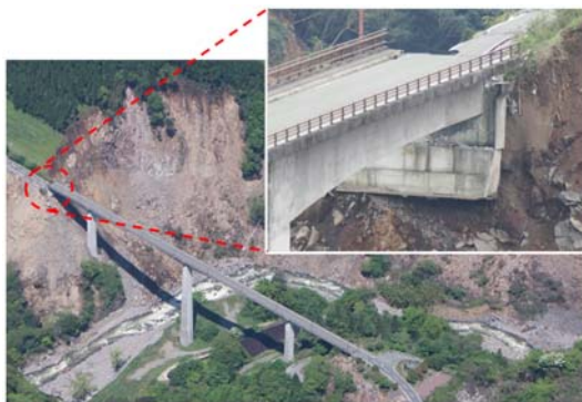
地盤変状による橋台の沈下
