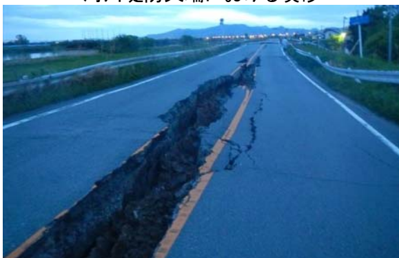
河川堤防天端の変状
