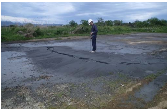
河川堤防天端における噴砂
