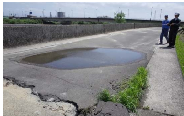
特殊堤の天端の沈下
