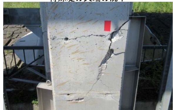
樋門の門柱の被災
