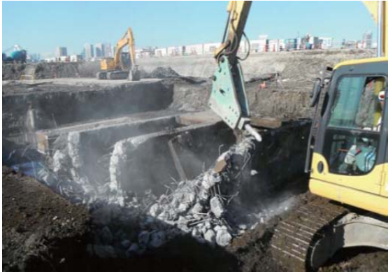
前の土地利用者の地中構造物が地中障害物として出現。
