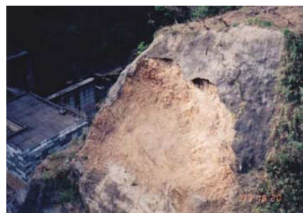
花こう岩への吹き付けのり面が背後地山の風化で崩落
