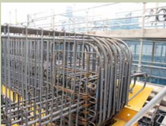
鉄筋が輻輳している例
