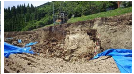
斜面上部の段差亀裂 (2017年6月5日撮影)
