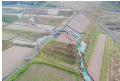
崩壊の状況 (2017年5月24日撮影)
