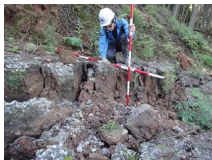
背後斜面の亀裂 (7月13日撮影)
