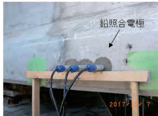
図-6 PCT桁橋でのセンサ設置（断面修復後のモニタリング）
