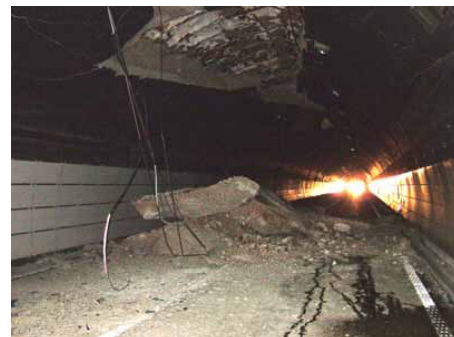
H16新潟県中越地震 和南津トンネル (写真提供: 北陸地整道路部)
