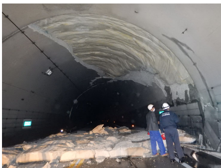
H28熊本地震 俵山トンネル
