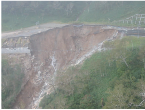
写真-5 H28年台風10号での盛土崩壊 (国土交通省 北海道開発局 帯広開発建設部 HP より)
