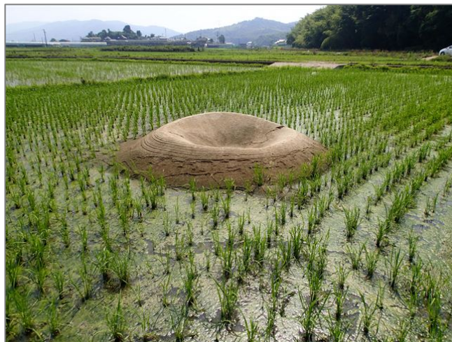
小田川の基盤漏水の痕跡(2018年)
