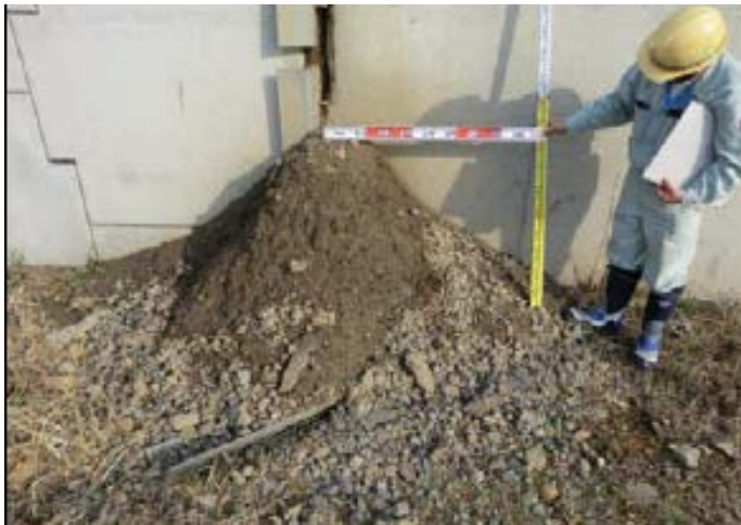
補強土壁の盛土材のこぼれ出し
