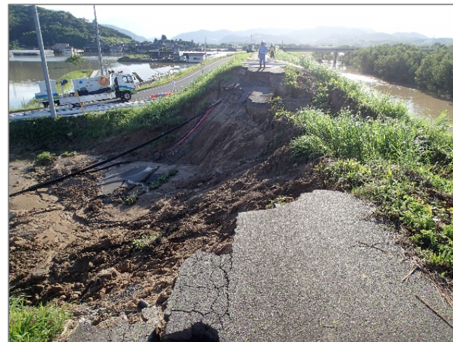
小田川の堤防の法すべり(2018年) 7
