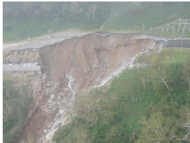
写真-5 H28年台風10号での盛土崩壊 (国土交通省 北海道開発局 帯広開発建設部HPより)
