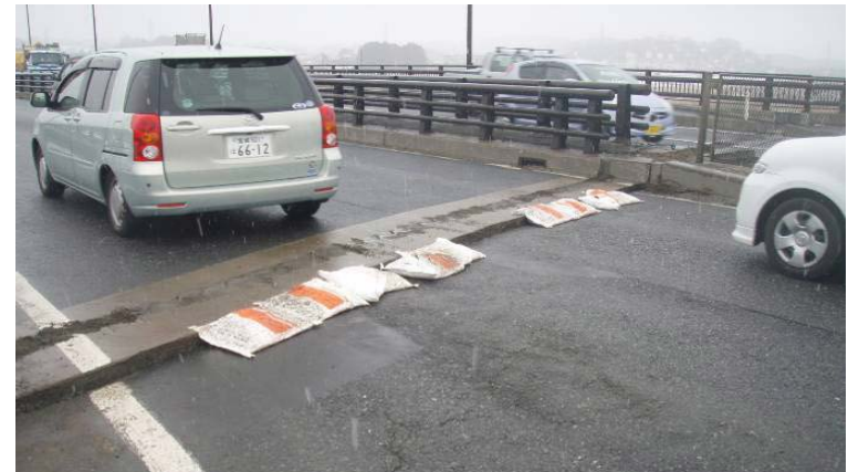
橋台背面の段差の発生
