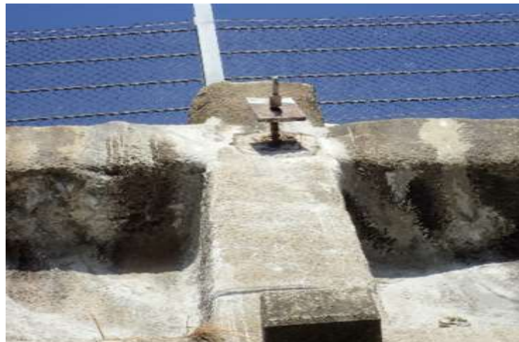
腐食により破断したアンカー
