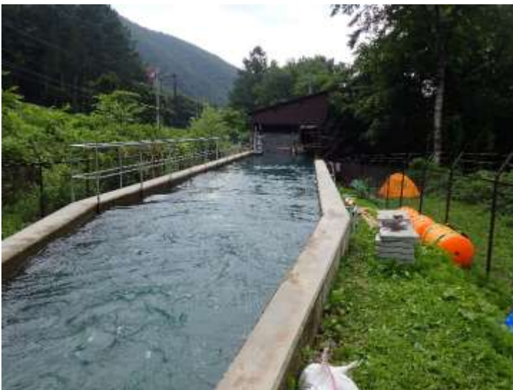
水槽兼沈砂池(運用中)
