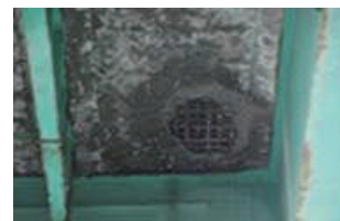
(b) 床版下面の抜け落ち時
