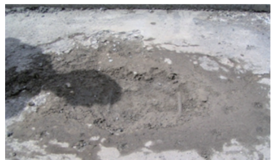
写真-1 コンクリート床版の土砂化
