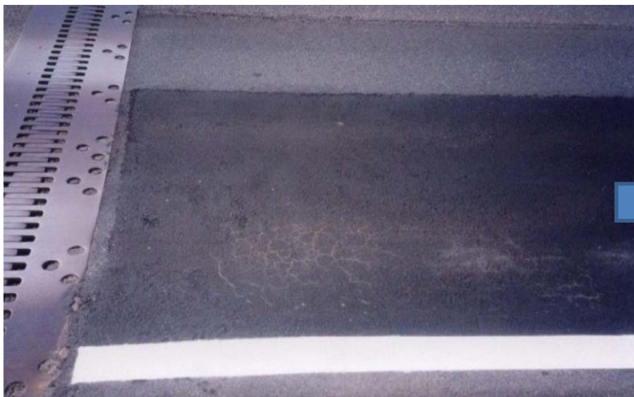
舗装のクラック
