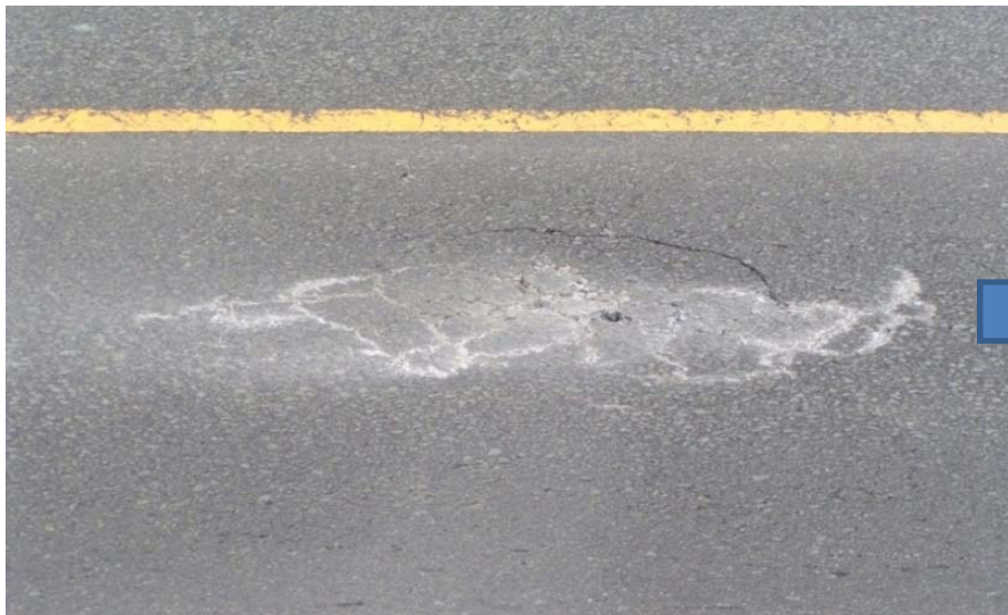
舗装の亀甲状のクラック
