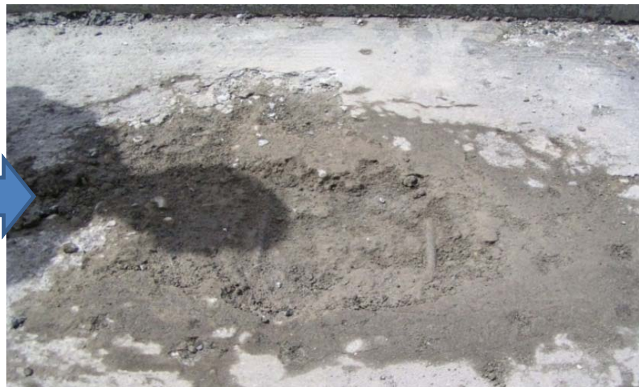
コンクリート床版上面の土砂化
