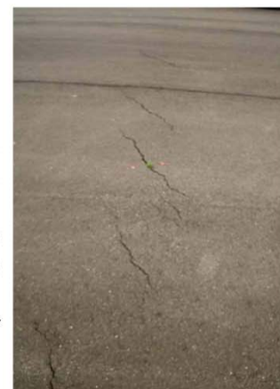
④雁行亀裂
