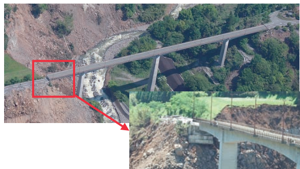
写真-1 斜面変状に伴って機能喪失した橋
