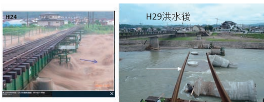
図-3 鉄橋倒壊事例 1)
