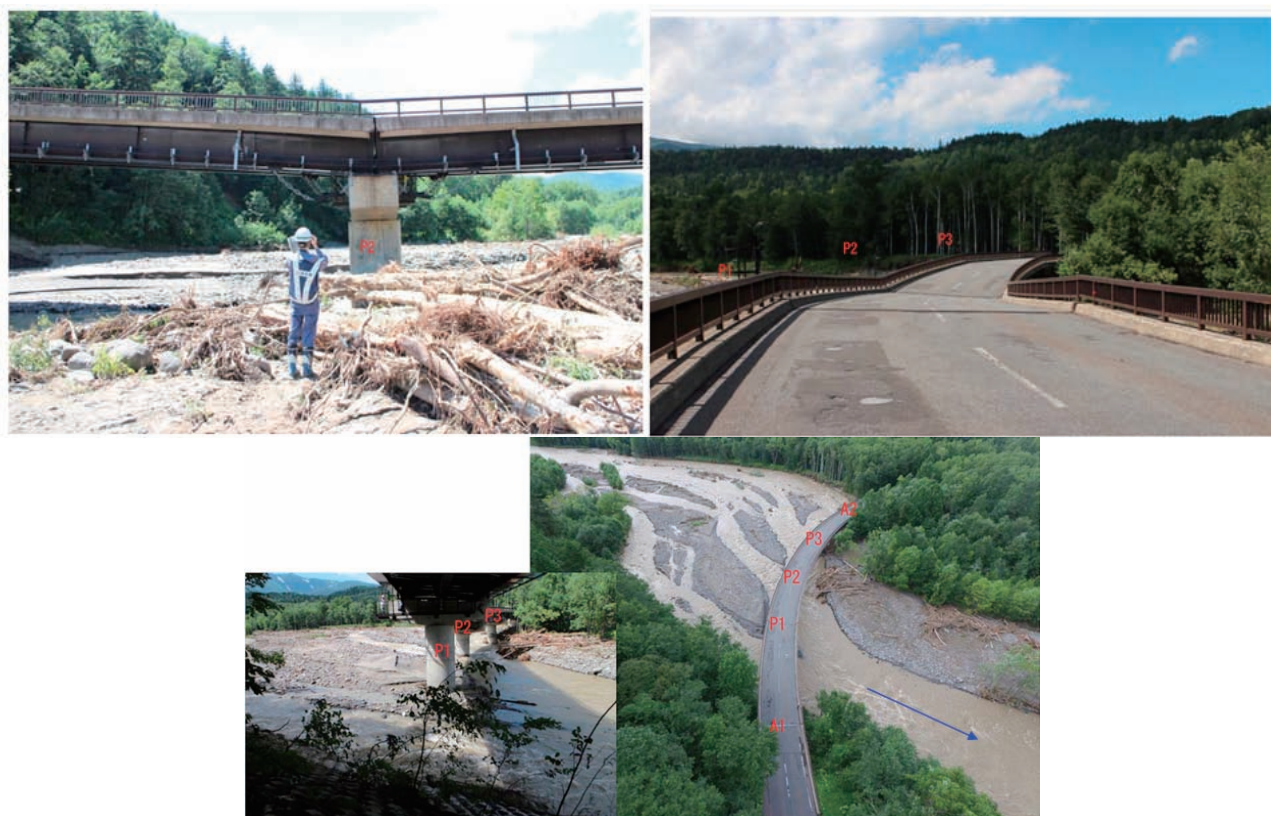
図-4 橋脚・桁の沈下事例 6)
