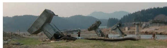
(b) 下部構造の倒壊も伴って機能喪失した橋 写真-2 津波の影響により機能喪失した橋
