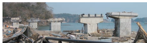
(a) 上部構造が流欠して機能喪失した橋
