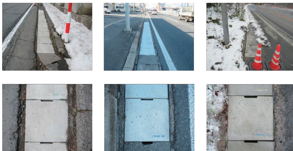
国道 46 号（岩手県雫石町）
