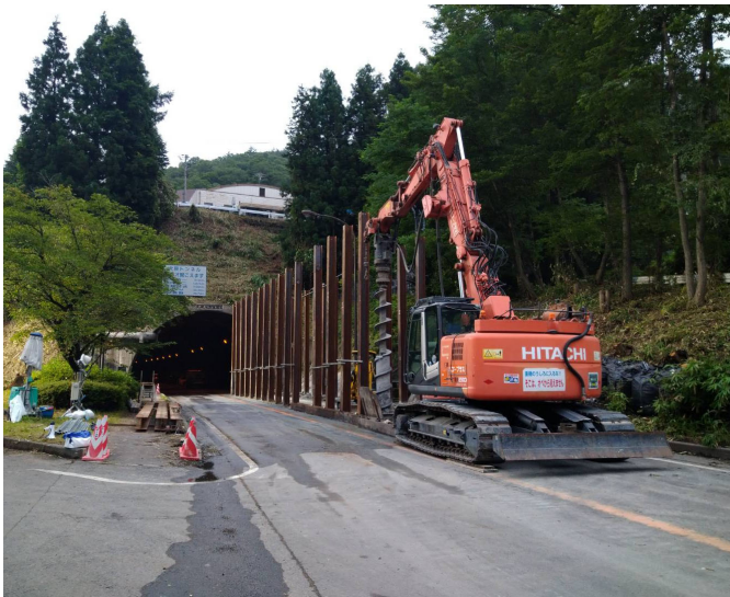
国道19号の対策(長野国道)
