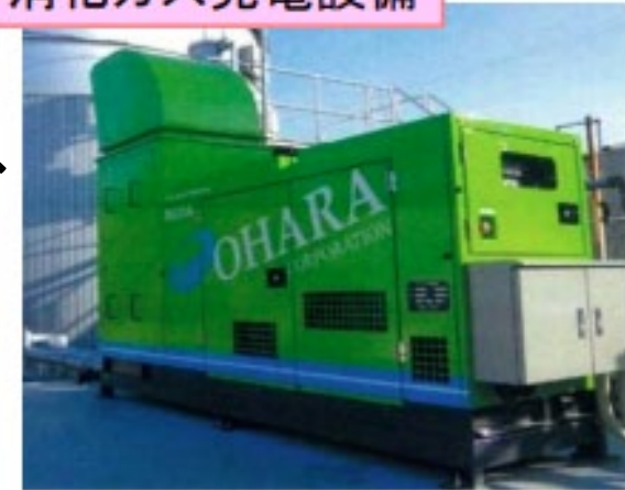
消化ガス発電設備
