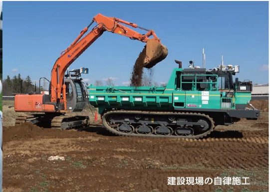
地すべり災害対応 CIM モデルを活用した災害調査
